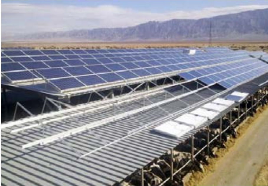
▲ Trang trại chăn nuôi bò sữa với hệ thống năng lượng mặt trời
