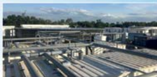
Nhà máy tái sử dụng nước thải KCN Tam Thăng, công suất 26.000 m 3 /ngày đêm
