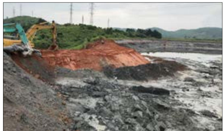
▲ Đập hồ chứa chất thải của Nhà máy DAP số 2 bị vỡ
